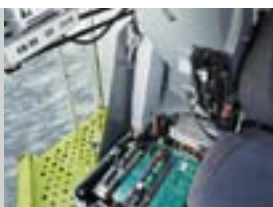
Todas las conexiones electrónicas se juntan en la cabina.
