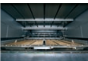
Regulación eléctrica de las cribas.
